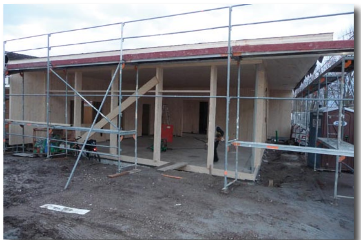
2.12.2008: Der Rohbau steht, die Fensterfronten können eingebaut und mit den Innenausbauarbeiten kann begonnen werden.
